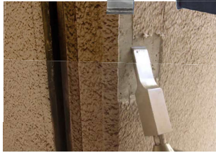
外壁塗装剥離
