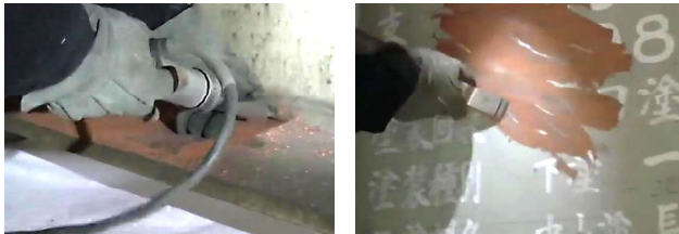
橋梁塗膜剥離
