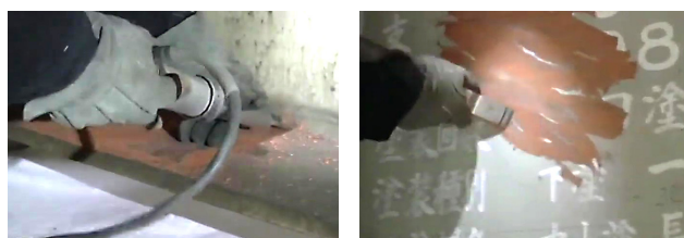
橋梁塗膜剥離
