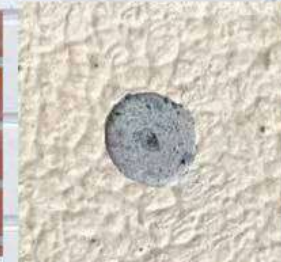
塗膜剥離状態
