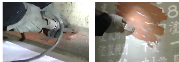
橋梁塗膜剥離
