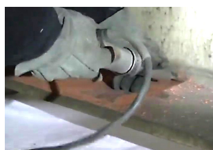
橋梁塗膜剥離
