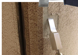
外壁塗装剥離
