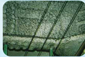
アスベストの現場
